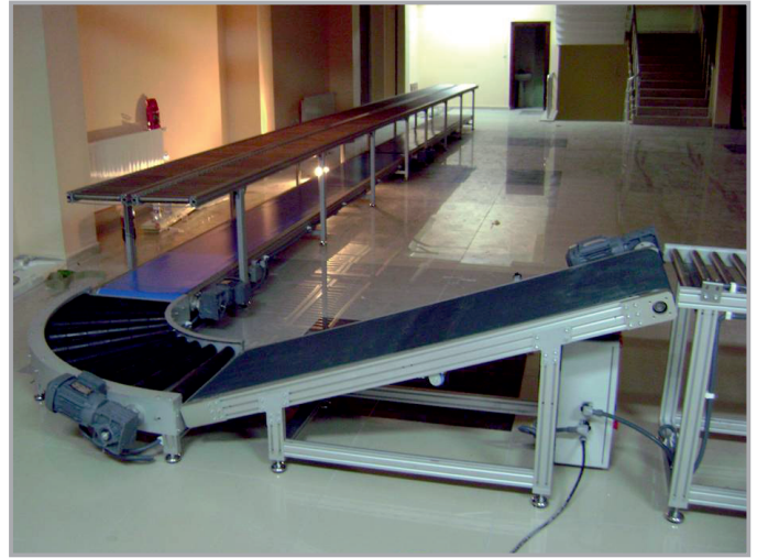
Lojistik Konveyör Hattı / Logistics Conveyor Line
